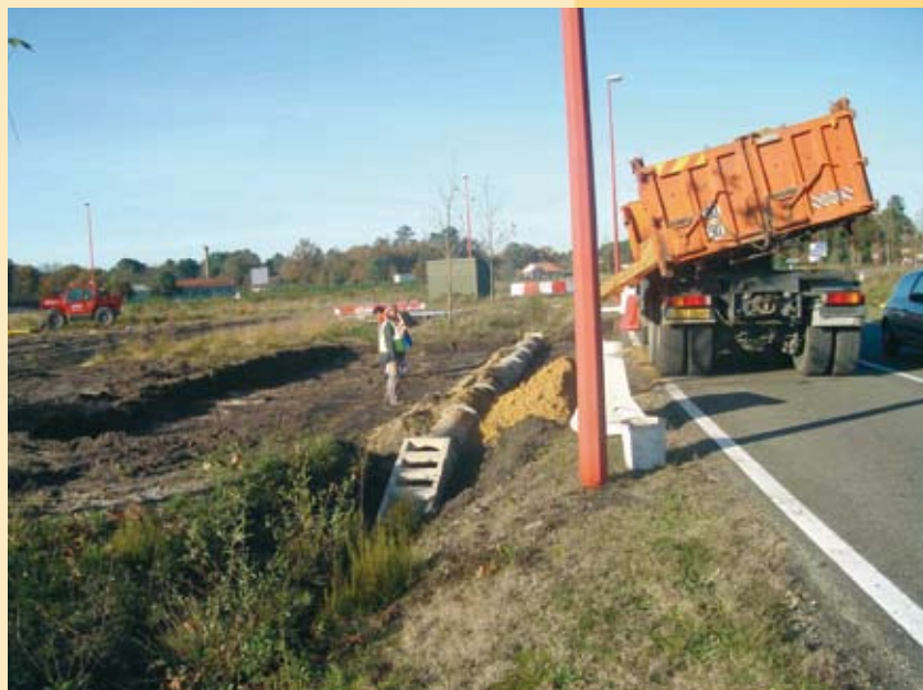
Travaux sur une entrée du Parc d'activité économique Haute Lande à Labouheyre
